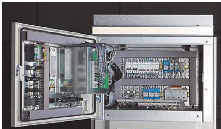
Рисунок 3.1.4. Релейный отсек КРУ 10кВ ИРиС
