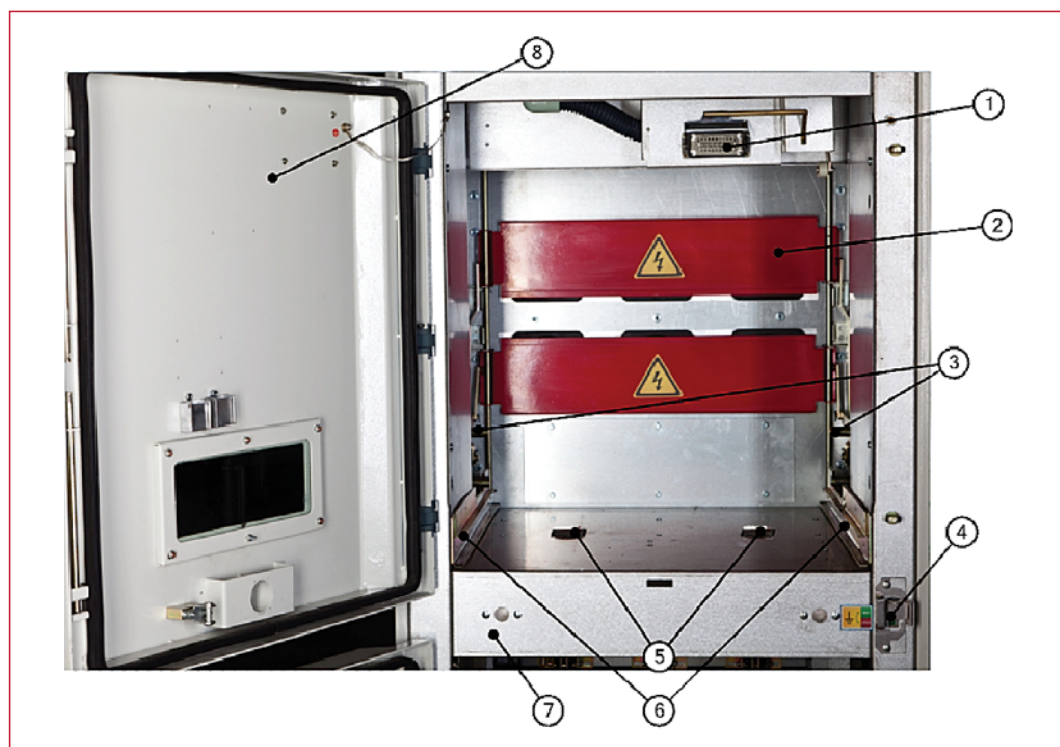
Рис. 2.5.4. Отсек выключателя КРУ ИРиС:
